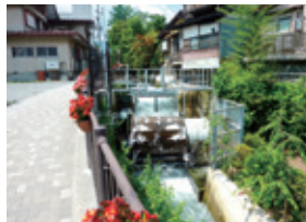
家中川小水力市民発電所(山梨県)の元気くん2号 写真出典：全国小水力利用推進協議会
