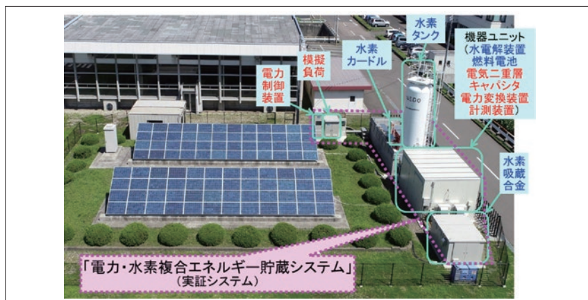
▲ 仙台市茂庭浄水場に設置された電力・水素複合エネルギー貯蔵システム
