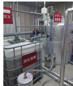
▲自立式小型メタン発酵システム「エコスタンドアロン」 実証第一号機
